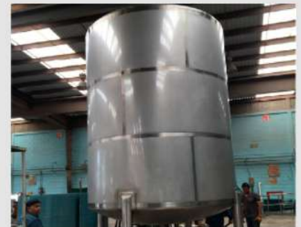
Tanques a Nivel
