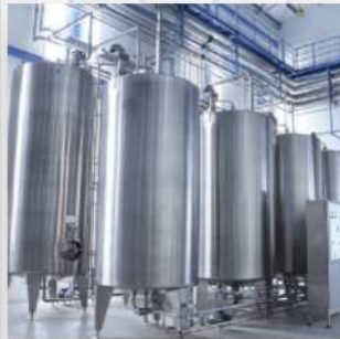
CISTERNAS Y TANQUES METÁLICOS PARA LÍQUIDOS
