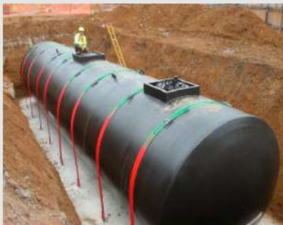
Cisternas Metálicas Subterráneas
